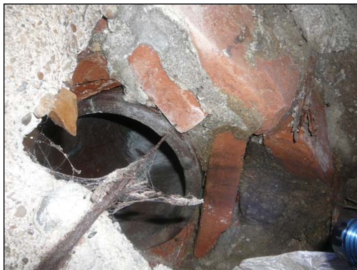
Foto /18/ Nesprávně zaústěné potrubí do pláště štoly, jde o systematickou závadu.
