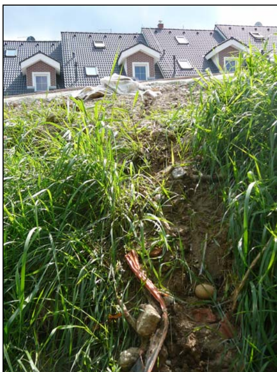
Foto /7/ Jedna z erozních rýh na boční straně tělesa vsaku - Anglický Resort v Cihelnách. Při přeplnění vsaku hrozí protržení vlivem hydrostatických a hydrodynamických účinků.
