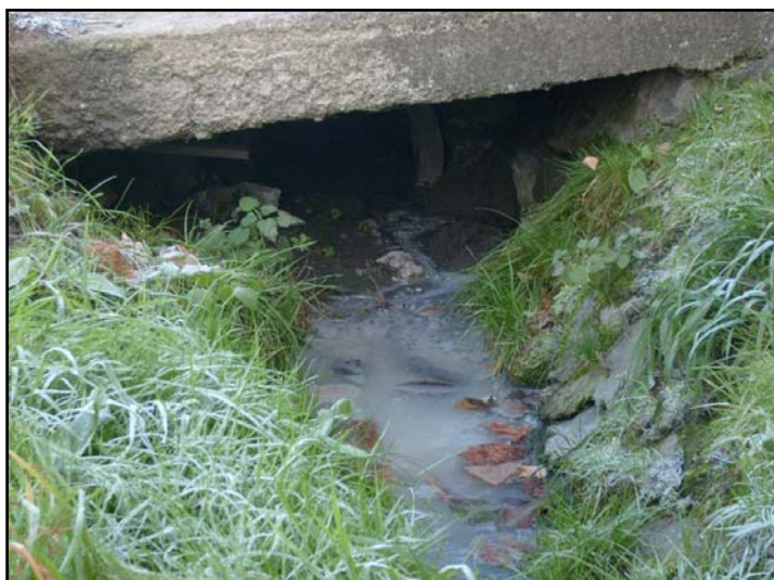
Foto /5/ Ulice V úvoze - vypouštění splaškové kanalizace do příkopů.
